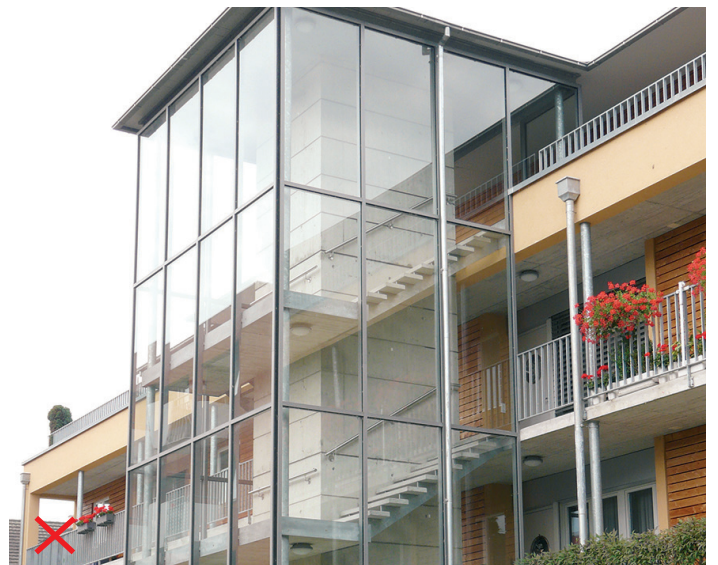
Abbildung 17: Dieses Treppenhaus bietet viel Durchsicht – für Vögel eine Gefahr. Zu markieren wären vorab die seitlichen Elemente. © Archiv Schweizerische Vogelwarte
